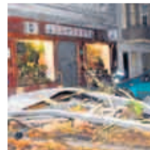
Cranachstraße 2: Sturm deckt Dach ab
