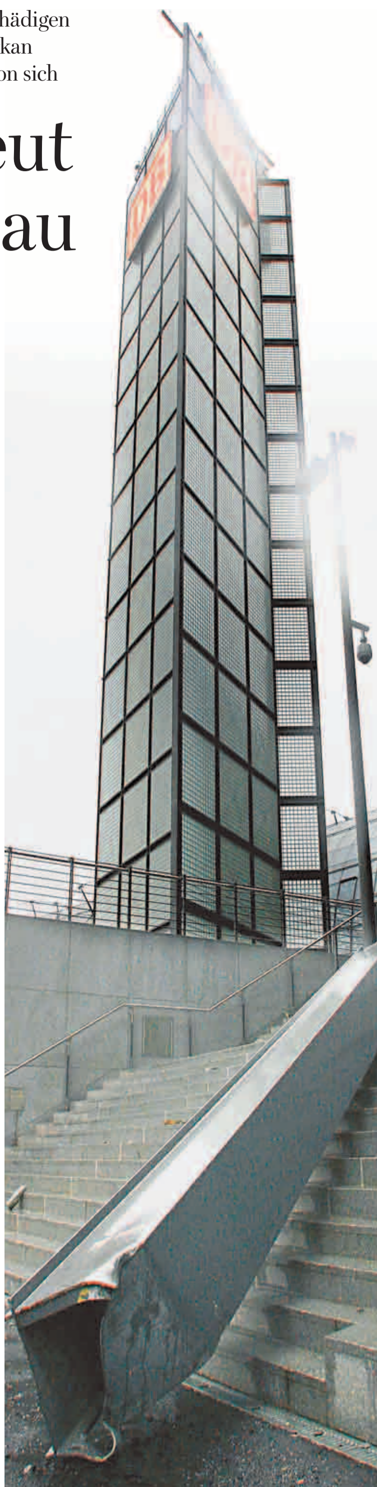
Ein herabgestürzter Stahlträger vor dem Hauptbahnhof. In der Nacht zu Freitag hatte Orkan „Kyrill“ den Träger aus der Fassade gerissen
